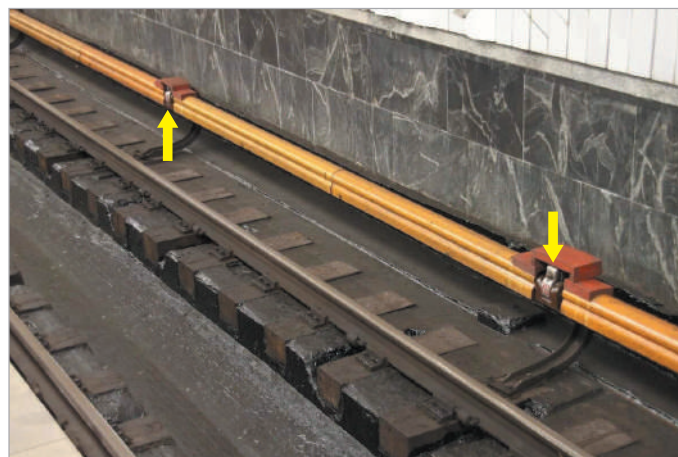
Рисунок 17. Контактный рельс метрополитена. Стрелками показаны узлы крепления контактной сети.
